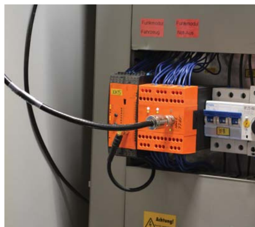
Die Sicherheits-Funkmodule von Dold sind im Schaltschrank in der unteren Etage bei der Strangpressanlage untergebracht.
