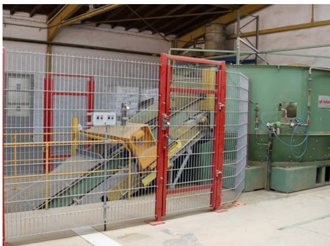
Sicherheitszäune schützen vor den gefährlichen Anlagenteilen in der Materialaufbereitung.
